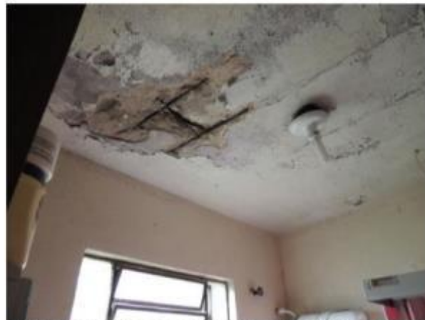
FOTO 10 – Casa Superior – teto do banheiro
